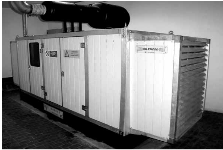
Gruppo elettrogeno Motore diesel: 6 cilindri in linea, cilindrata 8,1 l Potenza elettrica: 176 kW
